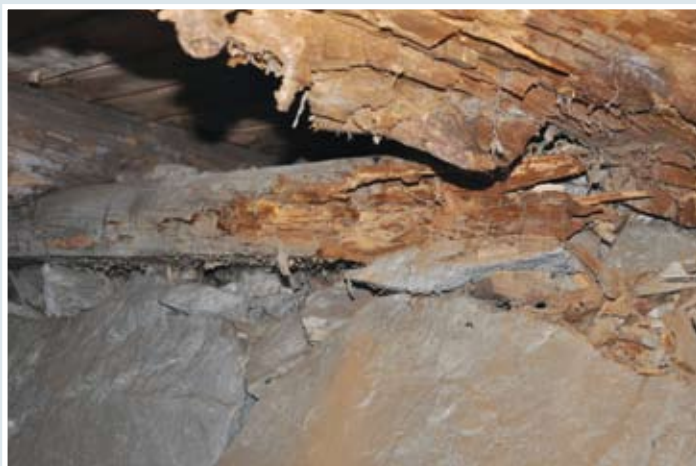
Dette var tilstanden for noen av bjelkene: Rett og slett råtnet bort!
